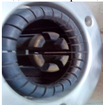
Рисунок 24 – Состояние контактной системы после режимов коммутации тока заряда шин 2А при напряжении 73 кВ (50 опытов) и ненагруженного трансформатора 2А при напряжении 73 кВ (20 опытов)
