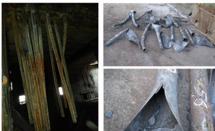
Рисунок 2 – Термосифоны, вышедшие из строя
